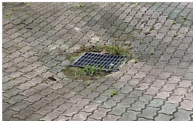
▲몸체 파손에 따른 누수로 주변 지반침하
