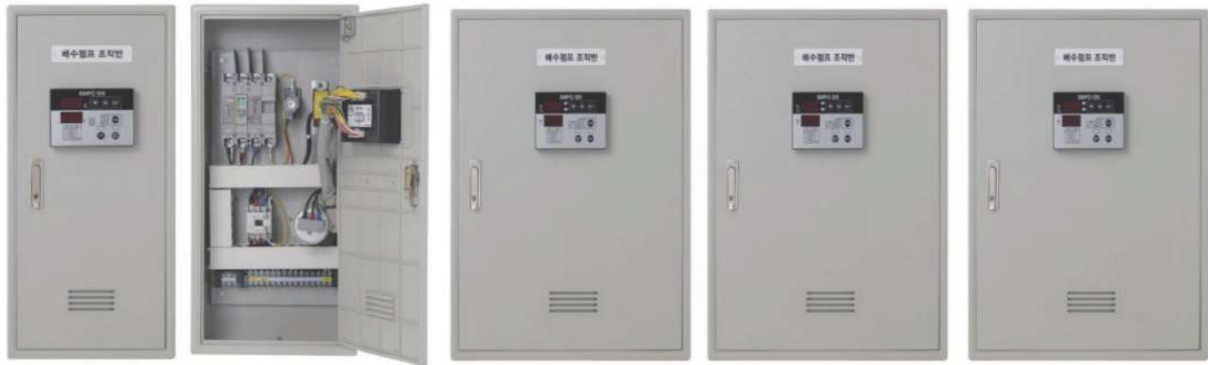
배수펌프 1회로 PVC함
