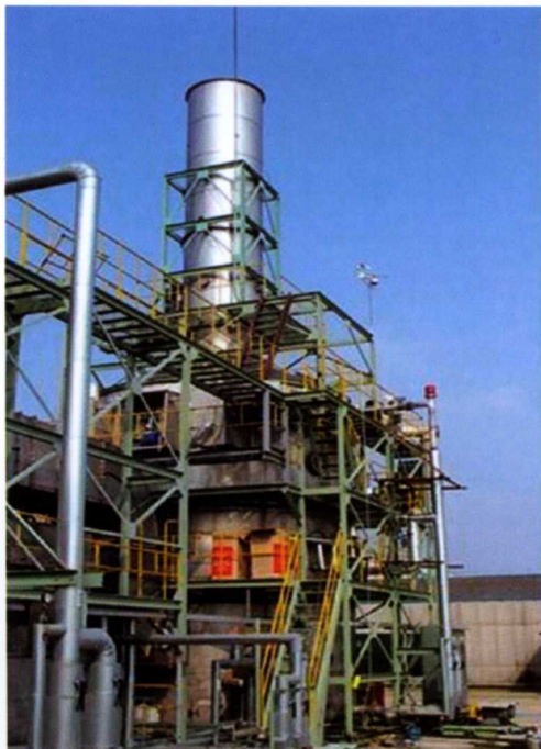
현대 자동차 도장라인 습식 전기 집진기
