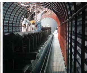
경사벨트 콘베어 내부 Inside of Slant Conveyor Belt
