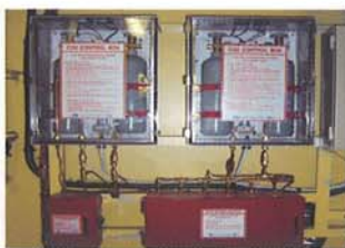
▲ CO2 Control Box Unit
